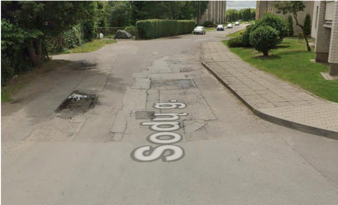
pav 4. Esamos gatvės dangos būklės pažaidos
