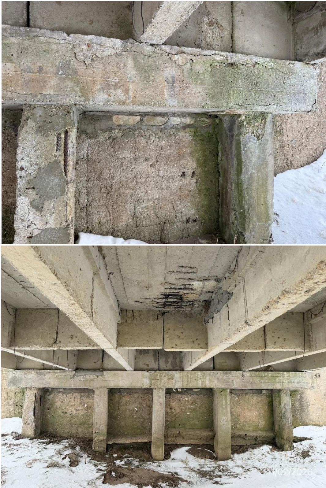
Pav. 4 Kraštinė atrama. Aptrupėjęs apsauginis sluoksnis, pažeistas apsauginis betono sluoksnis.
