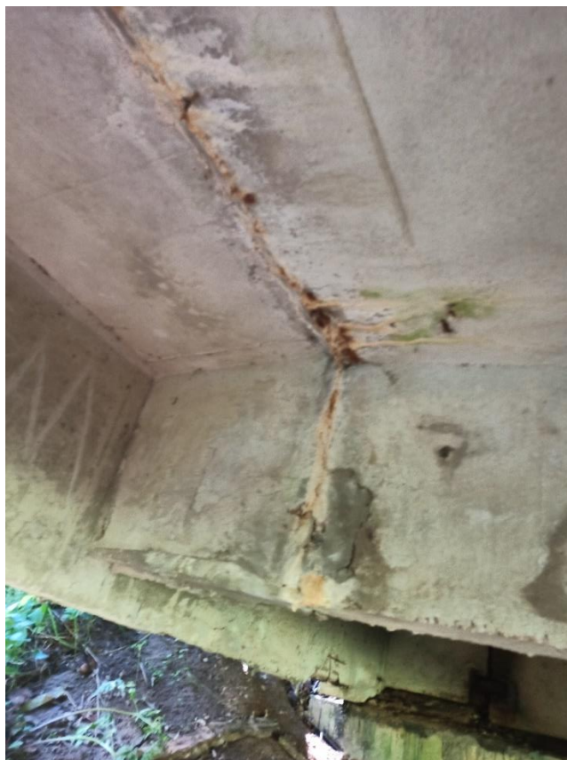
10 pav. Pažeistas hidroizoliacijos sluoksnis, vanduo skverbiasi per perdangos konstrukcijas
