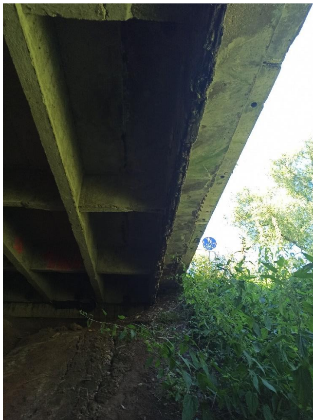
11 pav. Kraštinių sijų apsauginis betono sluoksnis pažeistas, koroduoja laikančioji armatūra
