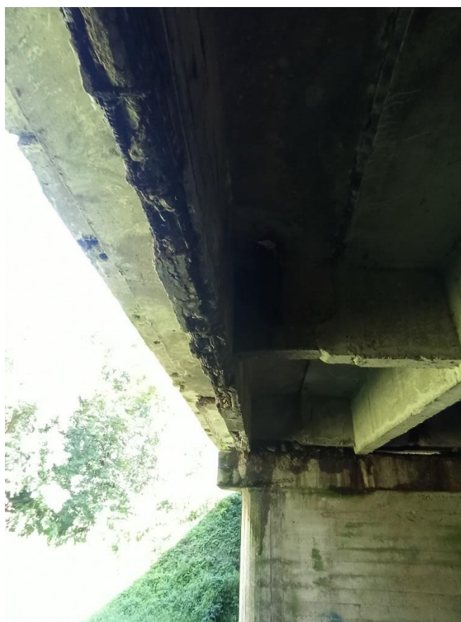
12 pav. Tarpinių atramų kamieno ir remsijės apsauginis betono sluoksnis pažeistas, koroduoja armatūra
