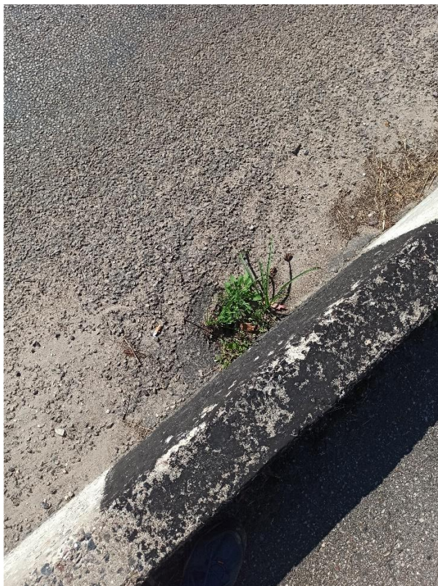
9 pav. Vandens nuvedimo šulinėliai užnešti, vandens nuvedimo vamzdžiai sukorodavę
