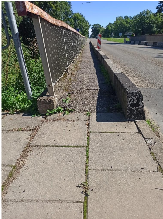
5 pav. Metaliniai tilto turėklai išsikraipę, pažeisti korozijos;
