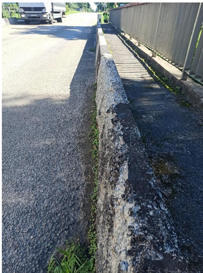
8 pav. G/b atitvarai sutrūkę, pažeistas apsauginis betono sluoksnis
