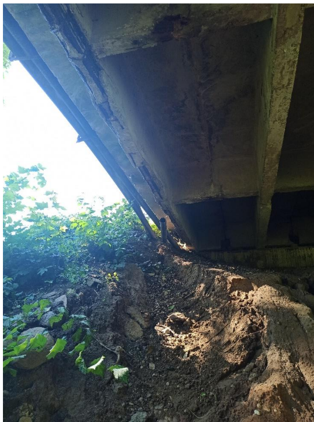
13 pav. Šlaitai ties krantinėmis atramomis paplauti, paplautas gruntas iš po pereinamųjų plokščių
